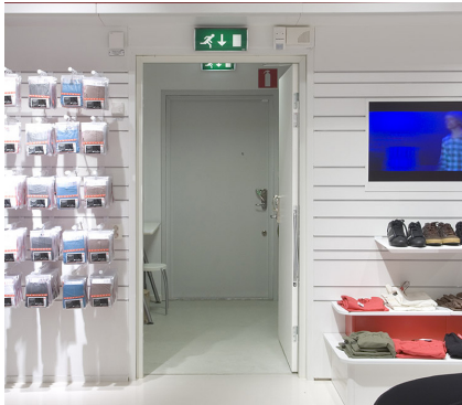
Tredør i butikk, og utenfor den en alarmbeskyttet og rømningsutstyrt sikkerhetsdør
